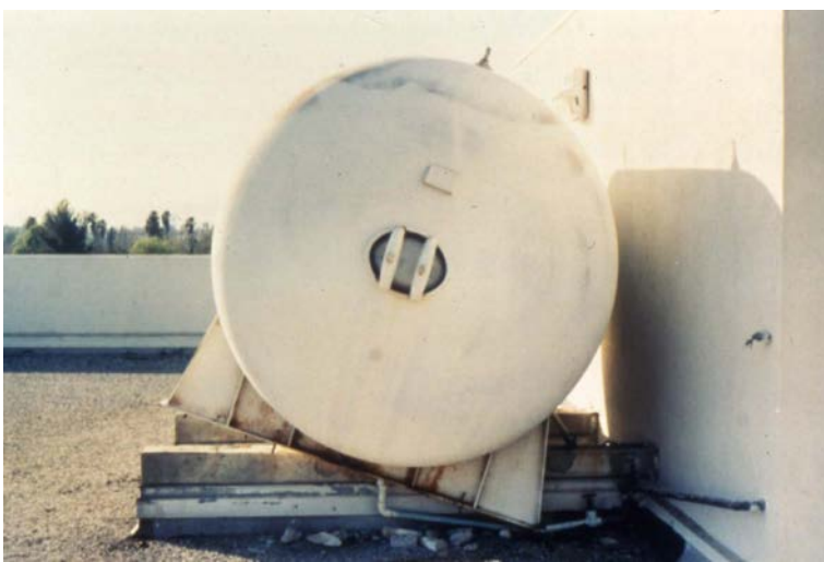
Figure 1.3-3 Glissement du réservoir hors de ses supports [65 : Séisme de Northridge, Granada Hills Hospital California USA 1994, Magnitude 6.7]
