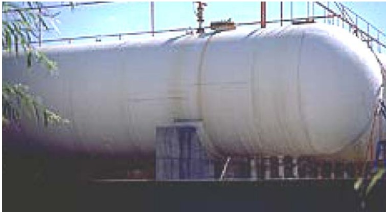
Figure 1.3-2 Glissement du réservoir sur ses supports [94 : Séisme de Marmara, Tupras refinery Turquie 1999, Magnitude 7.4]
